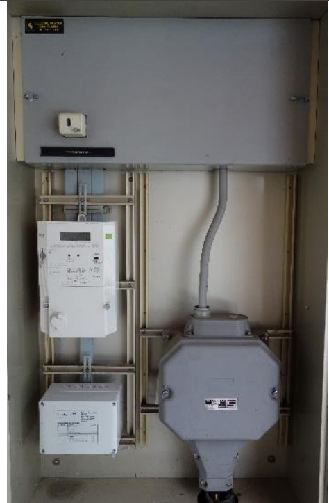
Abbildung 1: HAK, Smart Meter und Box
