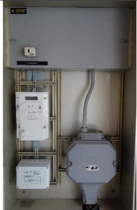
Abbildung 1: HAK, Smart Meter und Box
