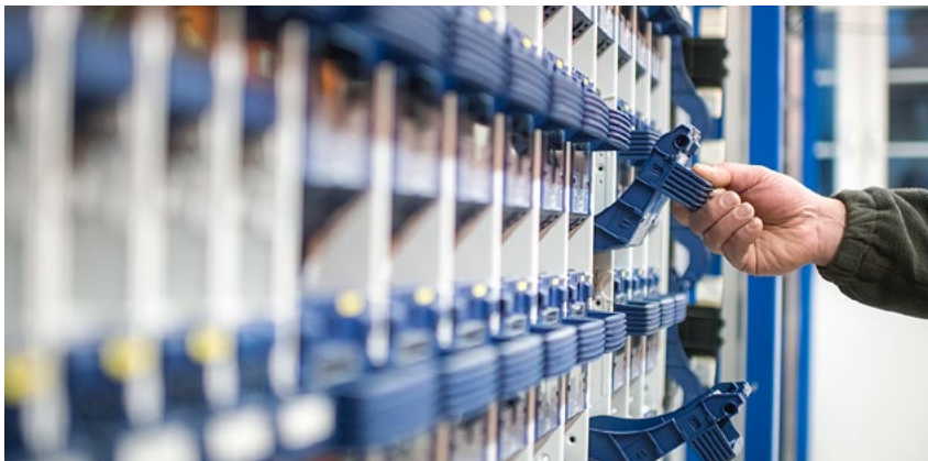
Herzstück der neugebauten Trafostation TS Salzhaus.
