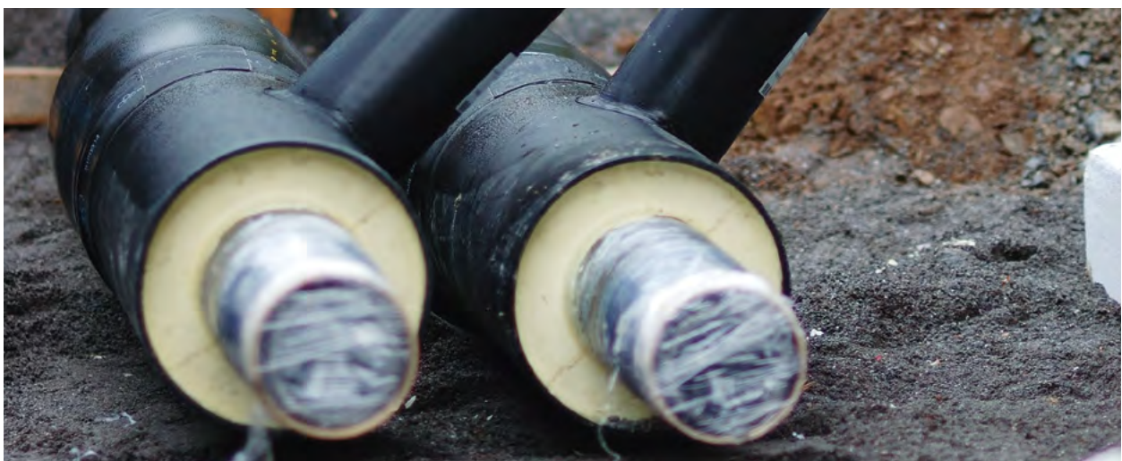
Vor- und Rücklauf Fernwärme UNO
