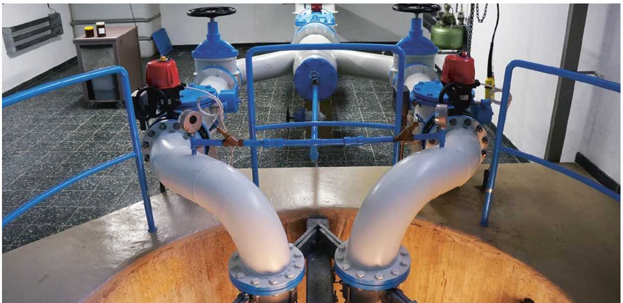
GWPW (Grundwasserpumpwerk) Buchholz, Glarus.
