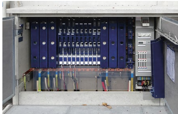
Die Kabine von innen: Linker Teil Stromabgänge; rechter Teil TV-Verstärker und Koaxialkabel für Kabel-TV.
