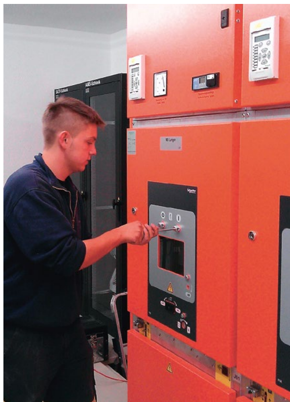
Inbetriebnahme der neuen Anlage im Adlergut durch Shkelzen Dema (Netzelektriker im 2. Lehrjahr).
