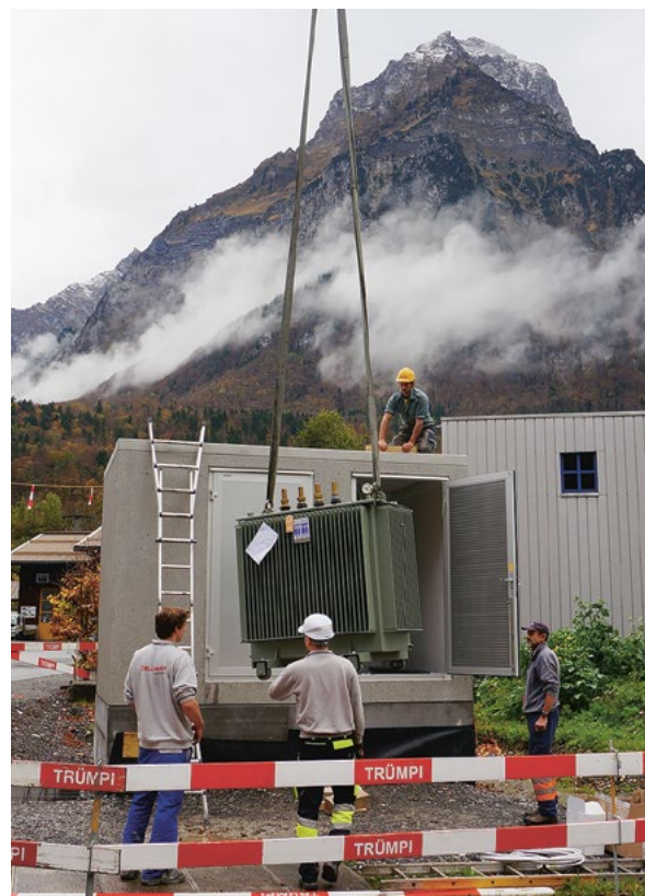
Die neue Trafostation Kapelle versorgt unter anderem auch das Areal der ehemaligen Teppichfabrik.
