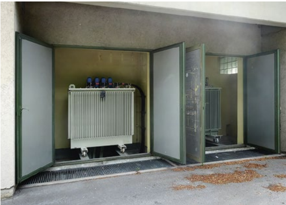
Liefert mehr Strom – der zusätzliche Transformator.
